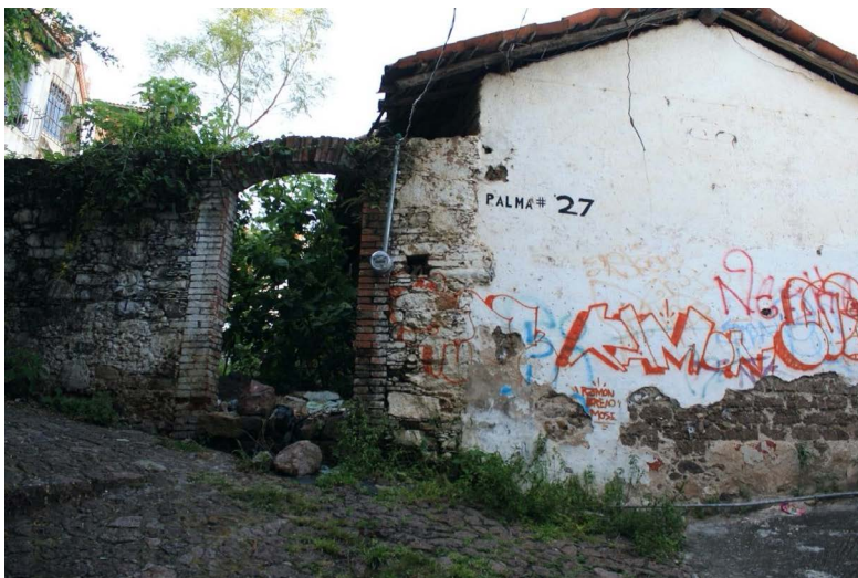
Imagen 45. Muro con un graffiti, en una casa abandonada, sobre un callejón poco transitado, en Taxco
