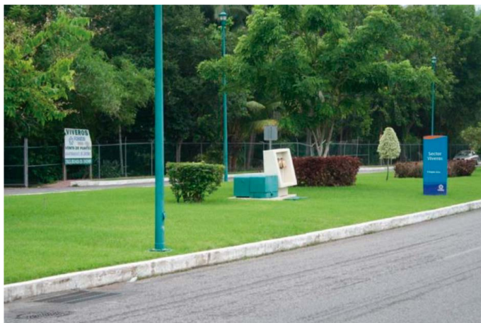
Figura 4.2. Cableado subterráneo en el CIP Ixtapa Zihuatanejo.
