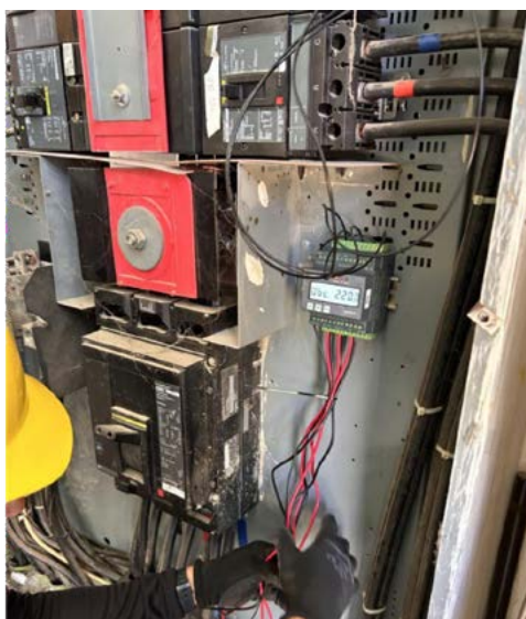
Figura 8. Sensor instalado en el centro de carga de las aulas amplias. Fuente: Elaboración propia.
