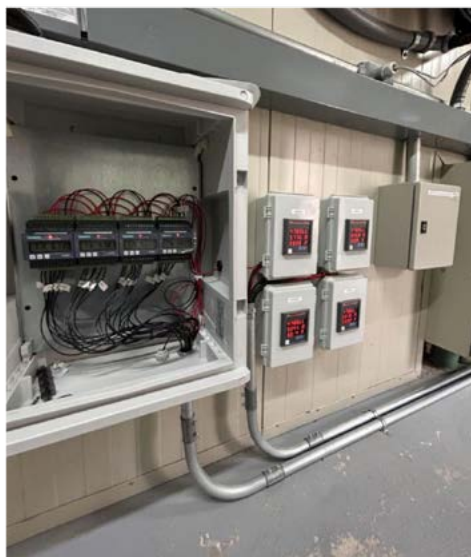
Figura 7. Sensores instalados en el cuarto de inversores del huerto solar fotovoltaico. Fuente: Elaboración propia.
